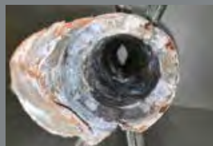
Шлам и первые признаки коррозии в контуре
