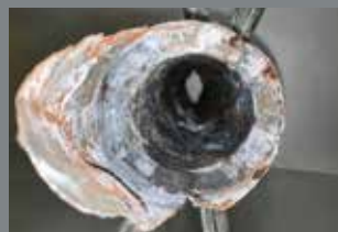
Шлам и первые признаки коррозии в контуре
